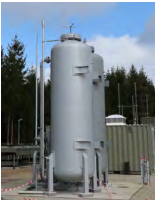
Foto nr. 03. Deodoriseringsanlæg.
