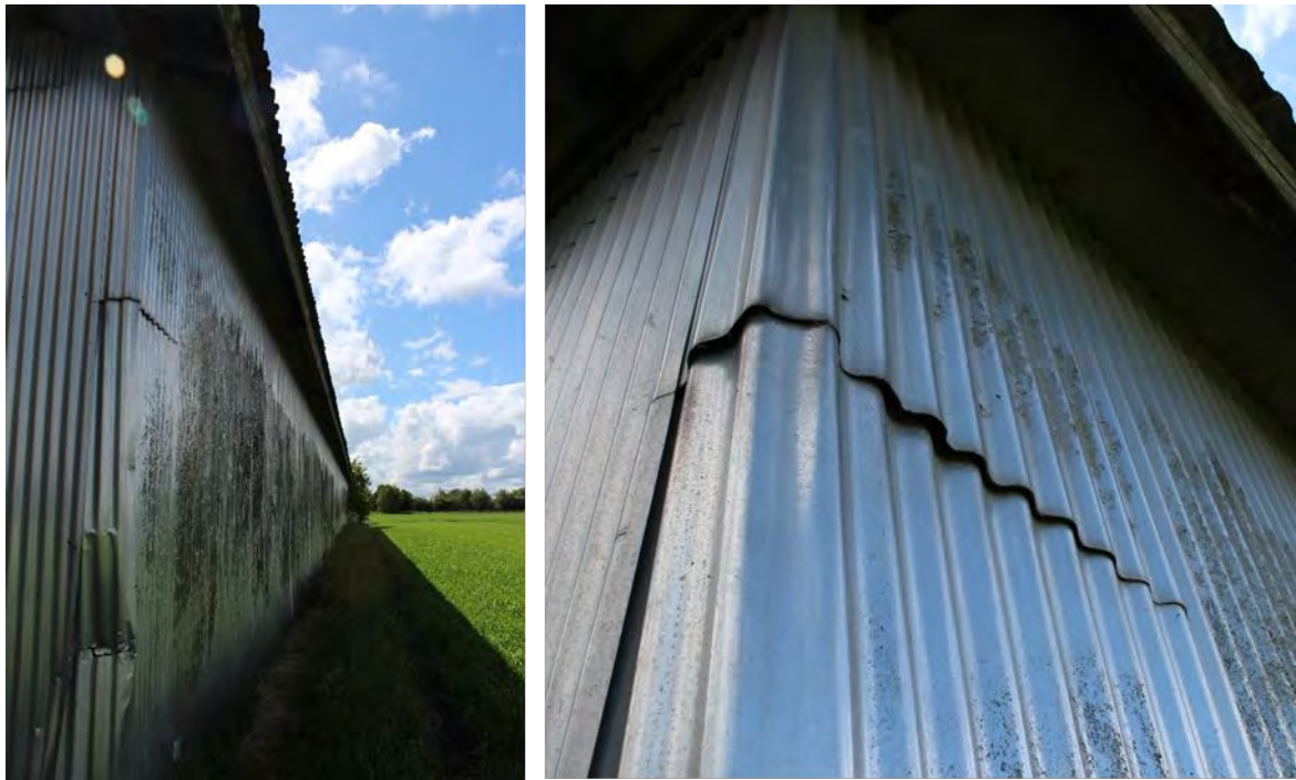
Figur 13. Billede 11 (venstre) og billede 12 (højre) viser sprækker i metalpladerne, hvor flagermus ville kunne komme ind og ud af laden.
